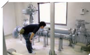
設備巡回点検中
